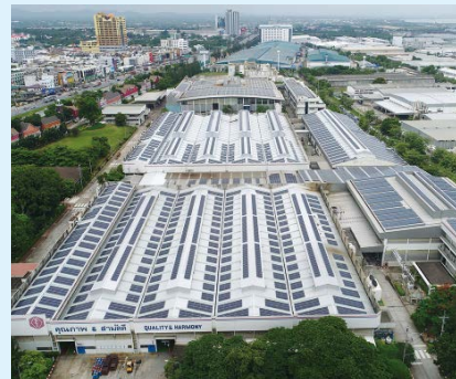
利用屋顶的太阳能发电系统
